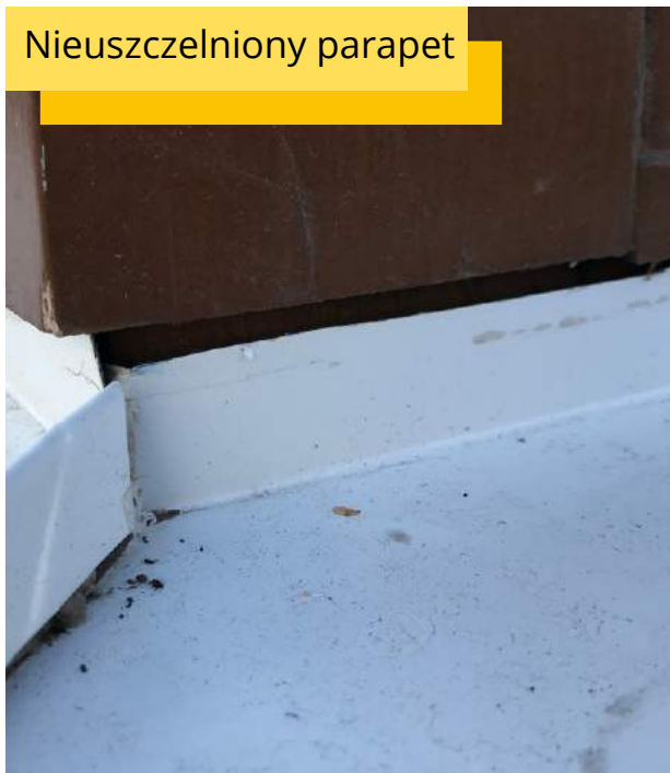
Spadek parapetu w kierunku okna -błąd
