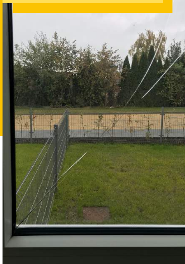
Pęknięta szyba - dow wymiany
